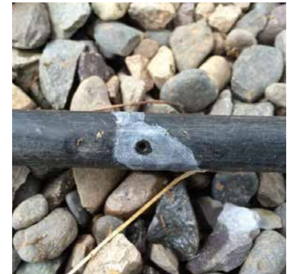
Goteros sin problema de obturación. Post aplicación de Flocucal
